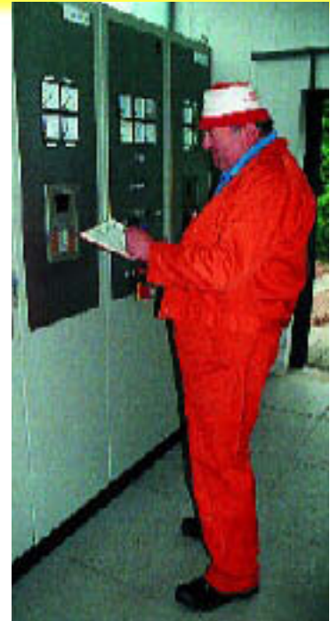
Kontrollarbeiten an der elektrischen Steuerung des Blockheizkraftwerks
