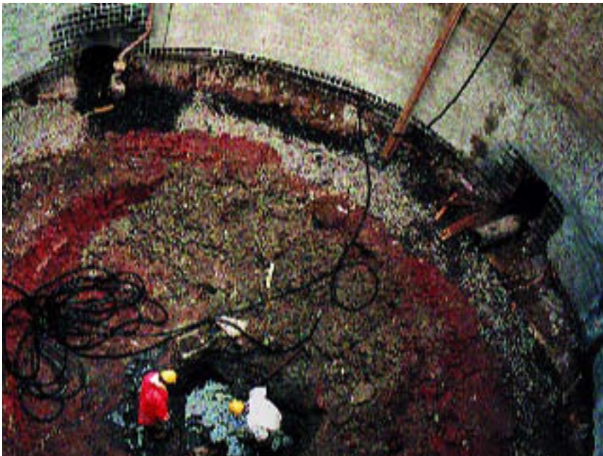
Blick in den 20 m tiefen und 11 m Durchmesser großen Zentralschacht, der durch den kompletten Müllkörper gebohrt wurde.
